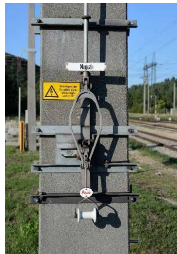
Abbildung 13a: Ladegleisschalter in Stellung „AUS“
