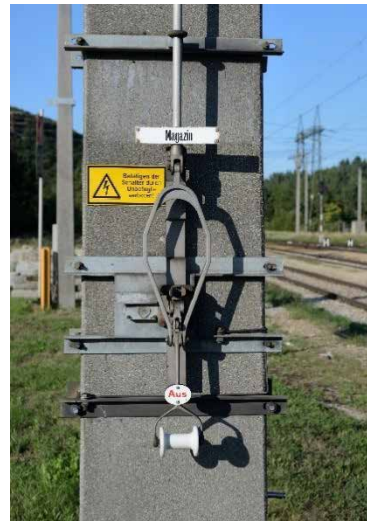
Abbildung 13a: Ladegleisschalter in Stellung „AUS“
